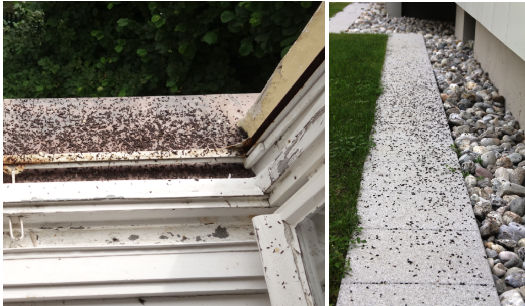
Abb. 1: Fledermauskot in geringem Umfang kann mit Besen und Schaufel beseitigt werden.
